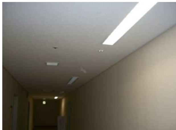
【間引き点灯の様子 病院外来棟 5 階】
